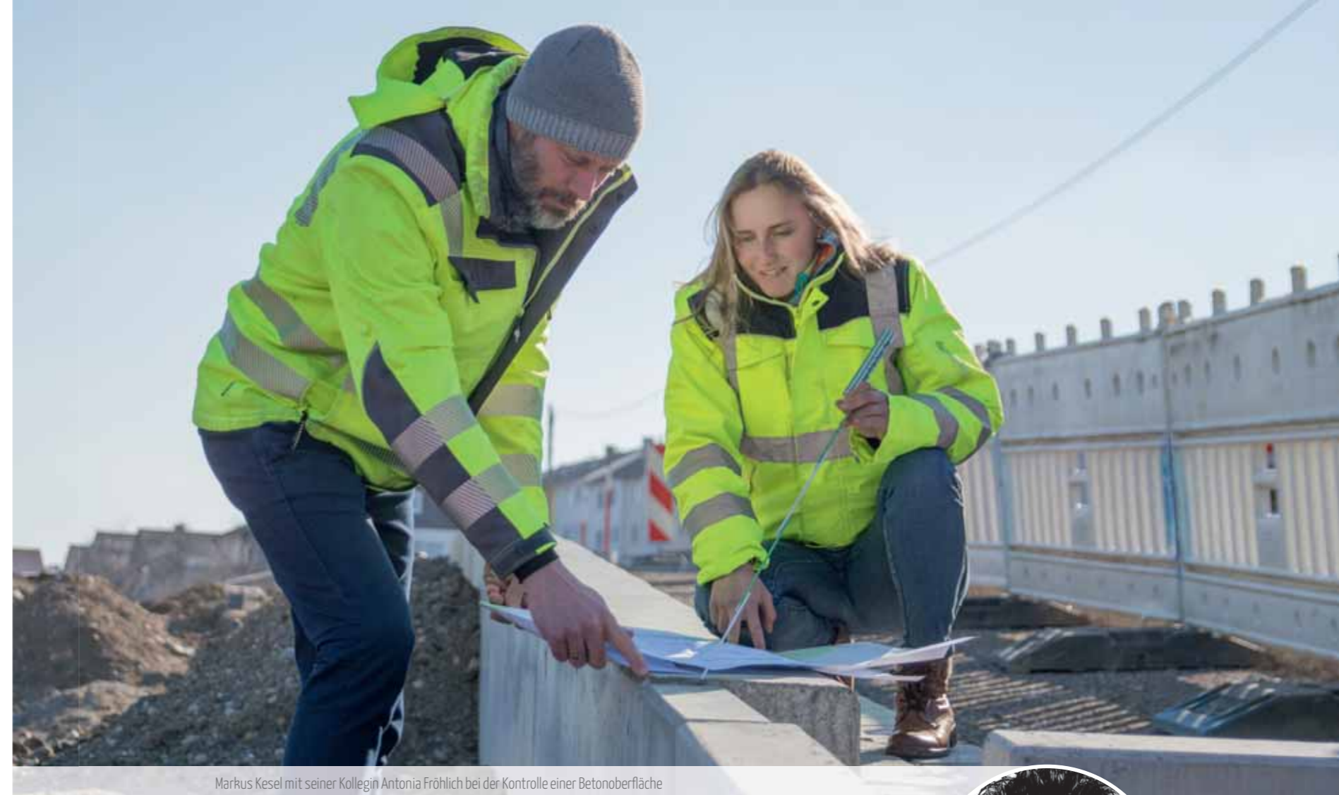
Markus Kesel mit seiner Kollegin Antonia Fröhlich bei der Kontrolle einer Betonoberfläche
